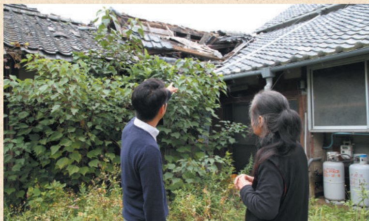
屋根が崩れてしまった家。親子3人が生活に困窮しており、フードバンク提供の食材を渡した
